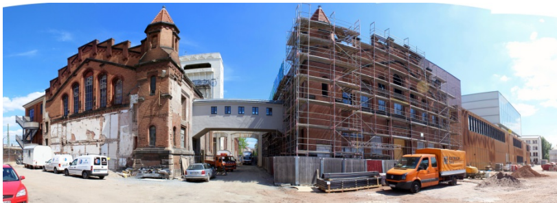
KKM - Kraftwerk Mitte; © SRH
