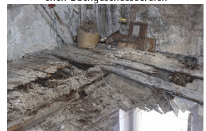
Bild 1: Durchgebrochene Decke im südlichen Dachgeschossbereich
