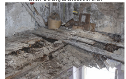
Bild 1: Durchgebrochene Decke im südlichen Dachgeschossbereich
